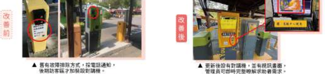
▲ 舊有故障排除方式,按電話通知,後期訪客需加裝對講機。 ▲ 更新後設有對講機,並有視屏畫面,管理員即時完整瞭解求助者需求。
