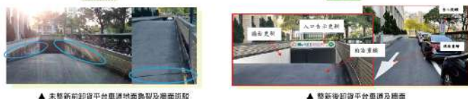
▲ 未整新前卸貨平台係重要貨運進出口 ▲ 整新後卸貨平台車道及擋面
